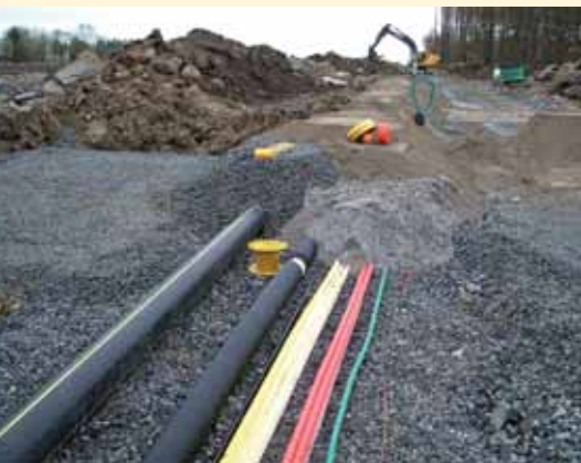
Biletet viser ei typisk kabelgrøft etablert av Per Magne Voll & Co
